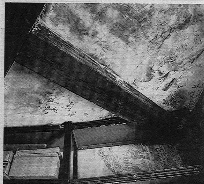
Las humedades han aflorado en algunos de los techos. H.F.
