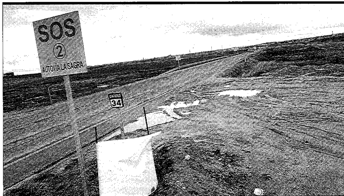
El tramo 2 de la Autovía de la Sagra (entre la A-42 y la CM-4001 en Borox y Añover de Tajo) comenzaron en abril de 2008. / C. GÓMEZ
