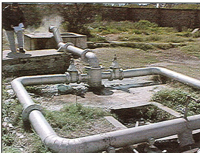
Conducto del agua
