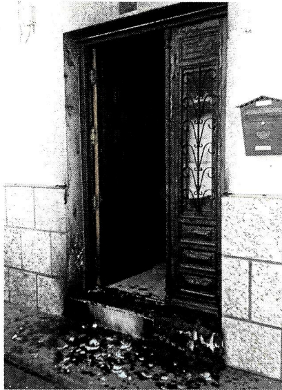
Estado en el que quedó la entrada a una vivienda de la calle Picota tras ser quemada por los okupas
