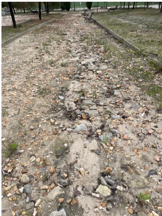
Imagen 3. Mal estado de caminos
